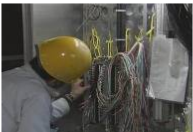
圖38：車上電氣箱配線
