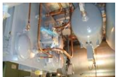
圖49：車下軛機設備
