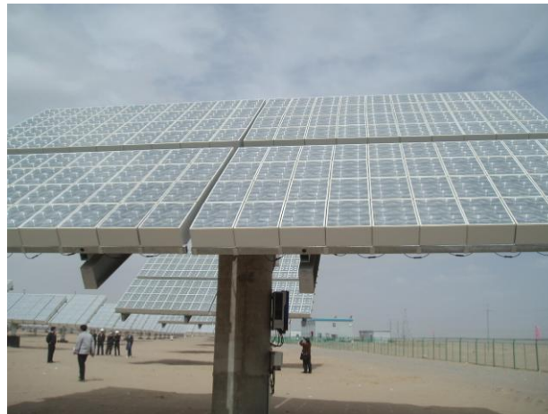
圖 25 國電電力太陽能發電站—西班牙 Isofoton 公司的 CPV 系統
