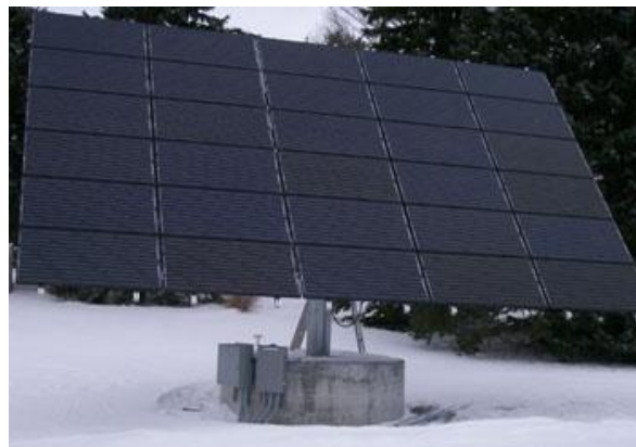
圖 8 常州常源光能科技開發的太陽光追蹤器
