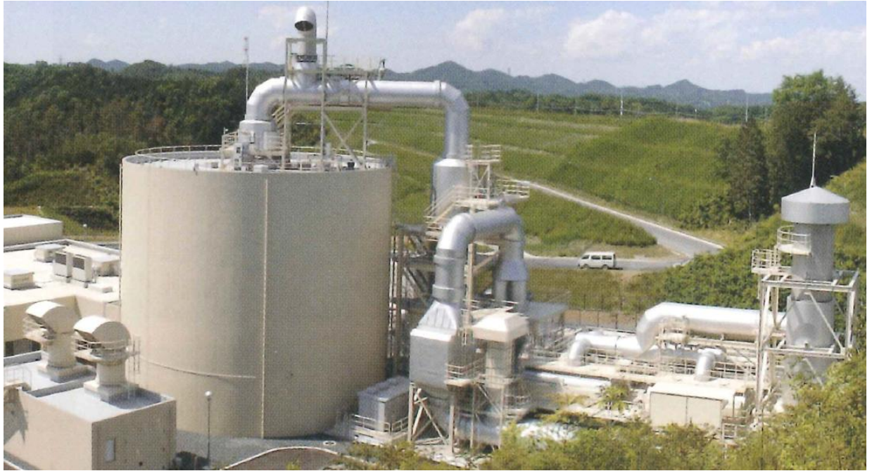
圖 11 防爆塔外觀及廢氣處理系統
