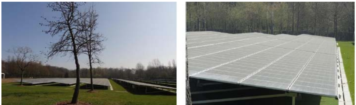
圖 5-6 Challenger Site 太陽光電裝設情形
