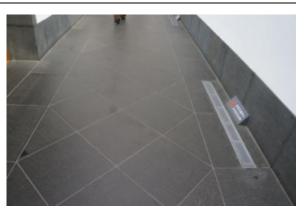
蘇州博物館新館空調出風口設置在地面，後續維護會造成很大困擾。
