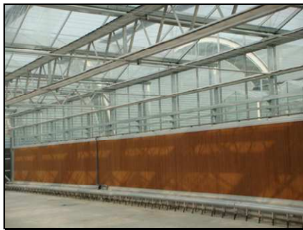
溫室配備風扇、水牆及地熱管
