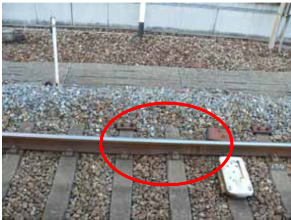
照片 3-69 塚本車站異形鋼軌
