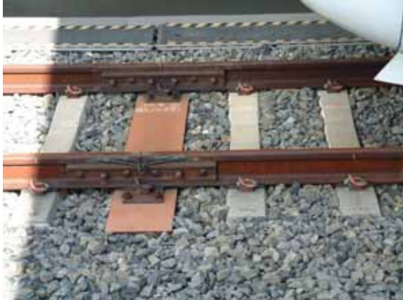
照片 3-77 合成枕木鋼軌接頭
