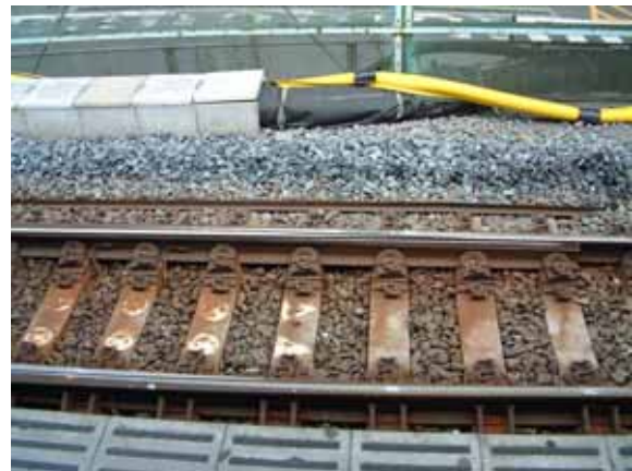
照片 3-76 曲線 EJ 外軌磨耗情況
