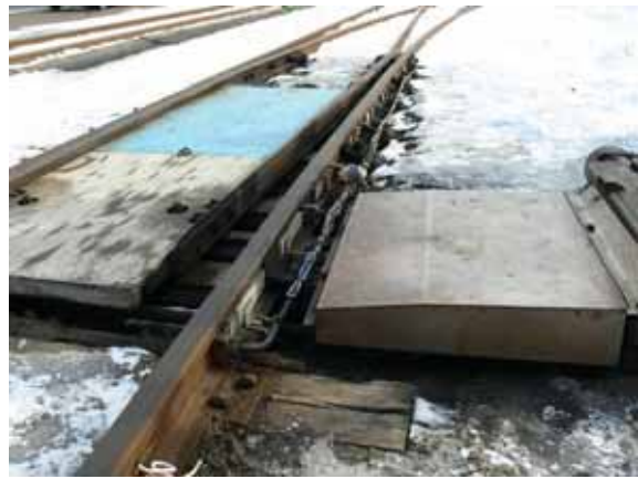
照片 2-50 道岔岔尖部加溫設備
