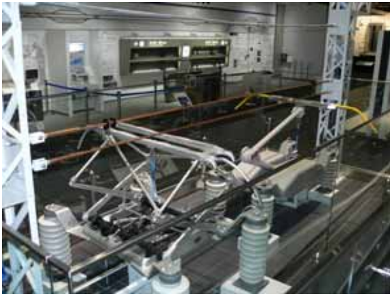
照片 2-127 機務-集電弓與電車線
