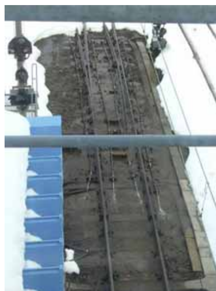
照片 2-102 直江津站轉轍器溫水噴射裝置
