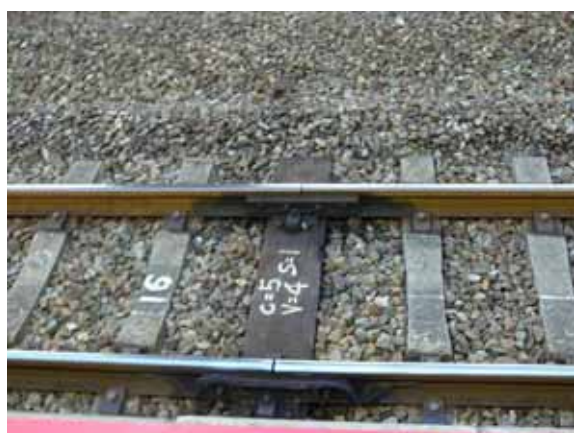
照片 2-144 站內路線鋼軌接頭
