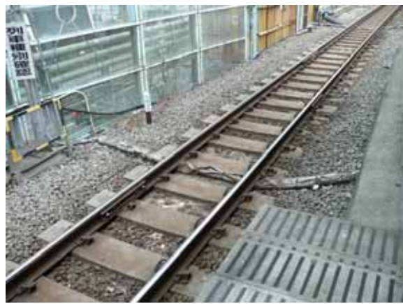
照片 2-60 TC 型軌道實況
