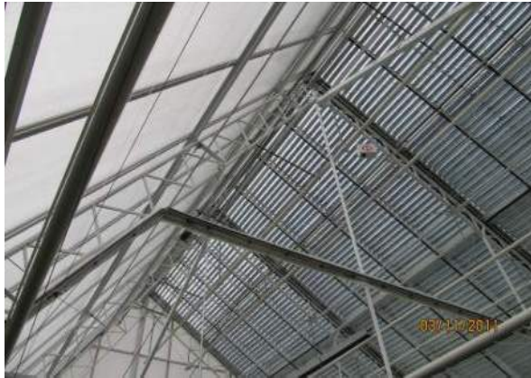
圖 89 溫室屋頂百葉板太陽能加熱管路
