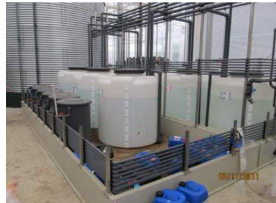
圖 62 各區溫室的養液調配儲存桶
