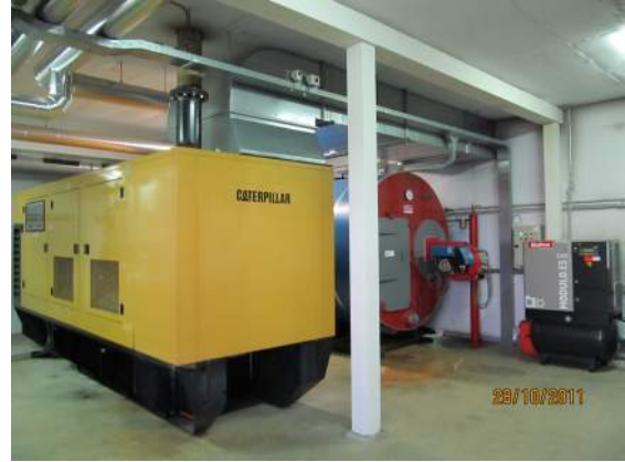
圖 166 備用電熱鍋爐與發電機
