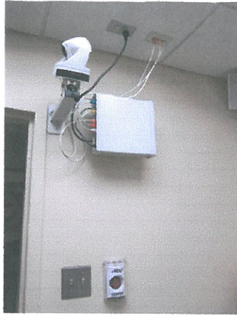
圖九、E-ICU 設備
