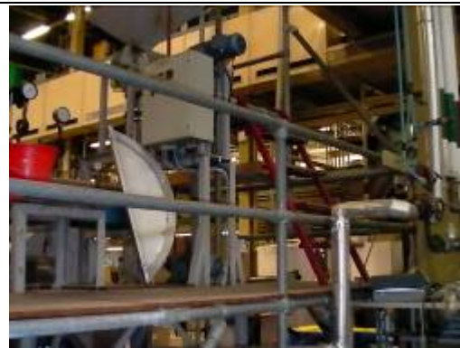
飼料廠內部相關管路。
