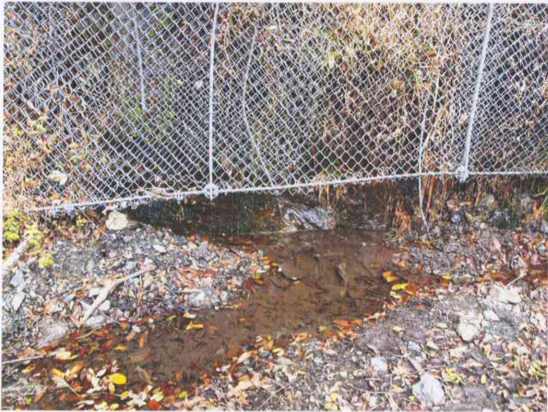
該地地下水豐富，隨處可見坡面地下水滲水之情形
