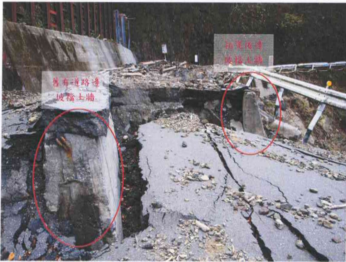
道路遭破壞後可見國道 168 號填土拓寬之歷程
