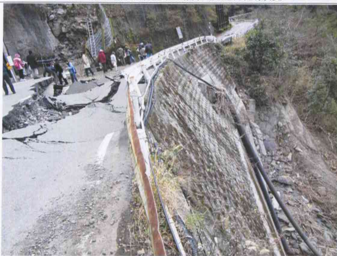
颱風造成道路沿線多處龜裂沉陷
