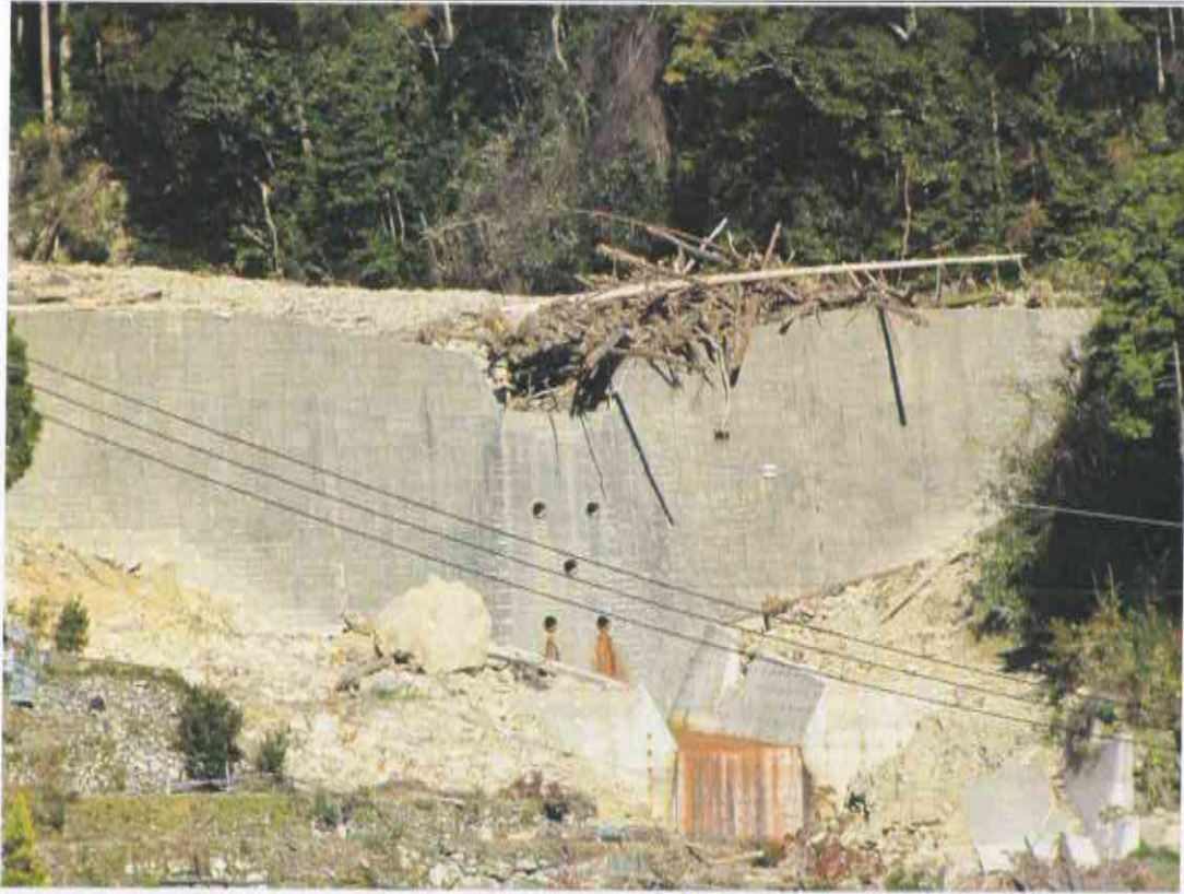
內之川野溪防砂壩災後土砂已淤滿
