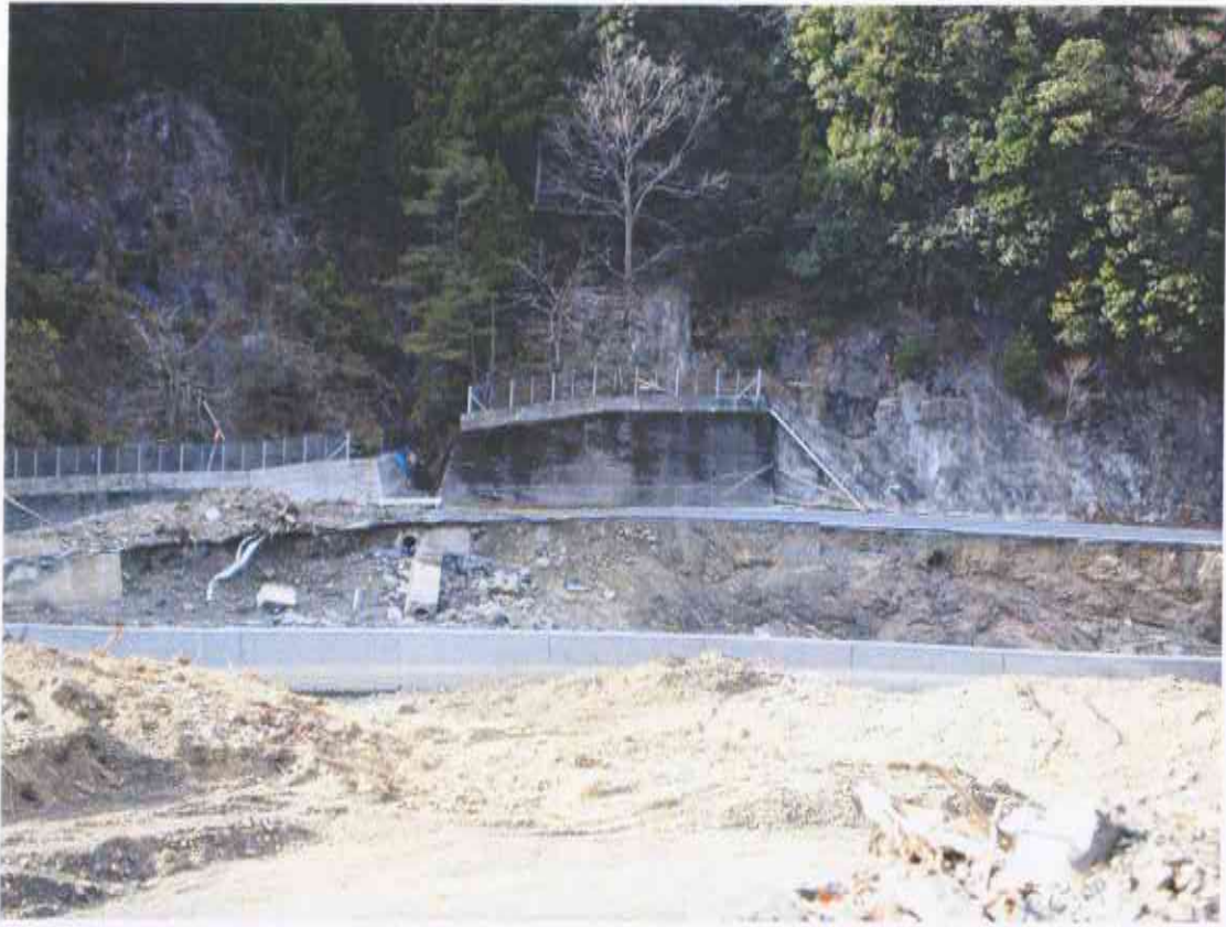
宇井地區熊野川沿岸道路多處崩壞
