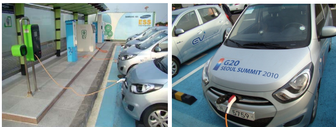
圖 16 濟洲智慧電網電動車充電設施
