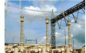
交流500KV送電線
