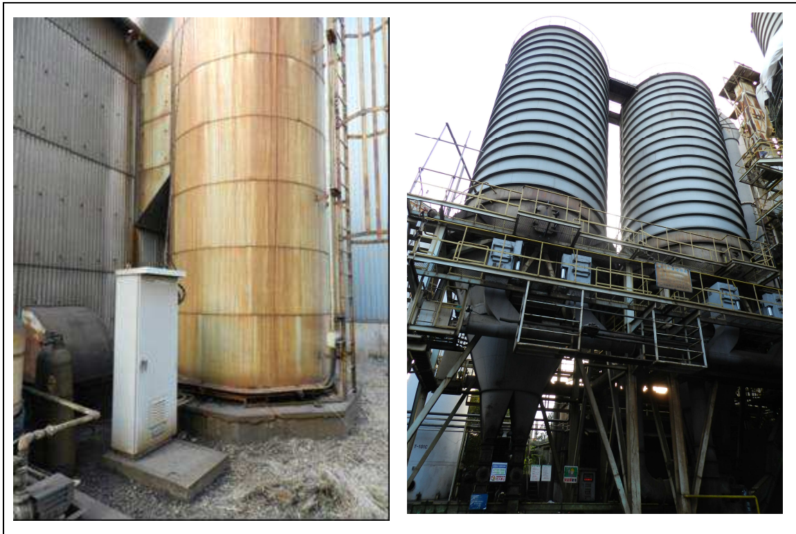
圖 4 中山鋼業直引集塵設備及自動監測設備
