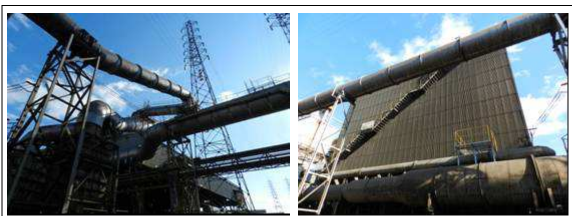
圖 15 合同製鐵直引集塵及建屋集塵匯合
