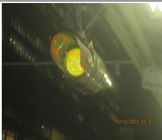
圖 4-25 出發預告號誌機(出發反應標識)—出發號誌視距不良時裝設之
