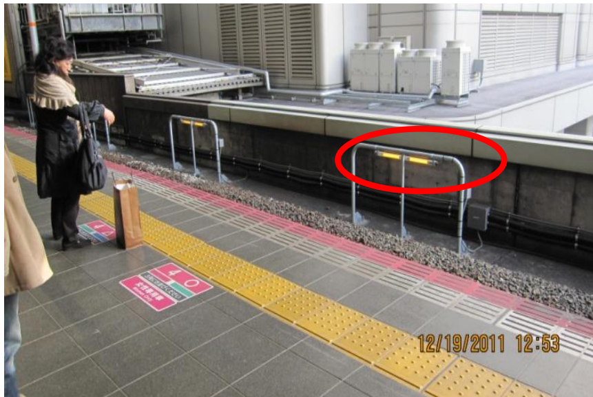
圖 4-9 有別於國內的列車進站警示燈，新大阪站的指示燈未設計於月台面上而是裝設於於軌道的另一側(如圖)可讓候車的旅客以不用低頭就可看到燈號，且 LED 燈在白天的時候亮度仍十分充足。
