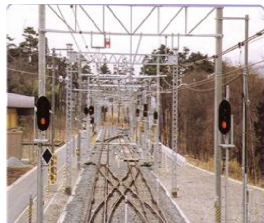
圖 5-10 實習線(Practice railway track)建置實際的電車線及 ATC 設備，提供一個訓練環境，來加強專業訓練。
