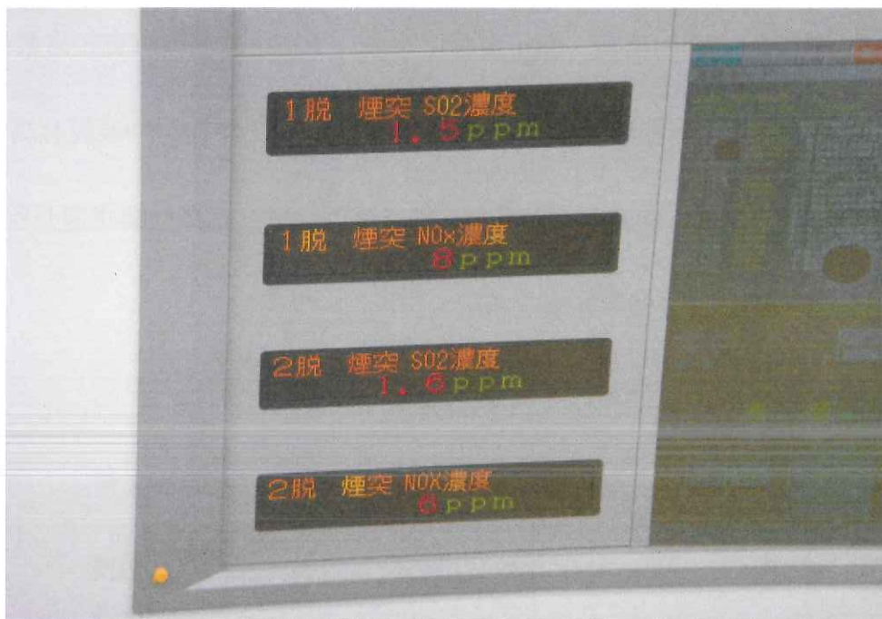
圖 3：磯子電廠控制室監控面板顯示煙氣 SO 2 、NO x 排放濃度
