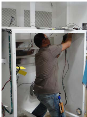
工廠配線情形
