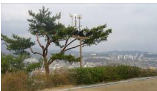
圖 63：華城將臺之無線控制照明設備
