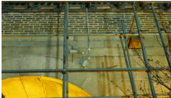
圖 29：東大門壁體之位移監測
