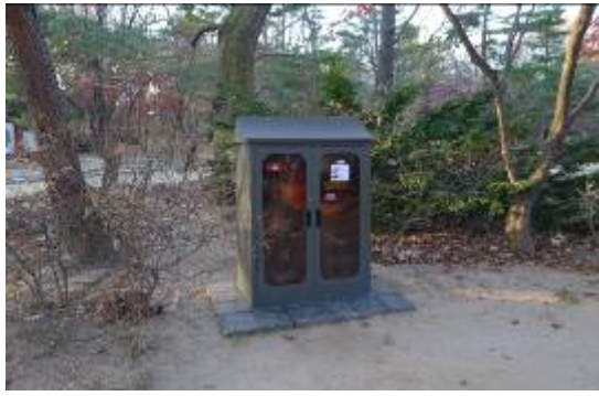
圖 11：庭園內設置之消防栓(宗廟)
