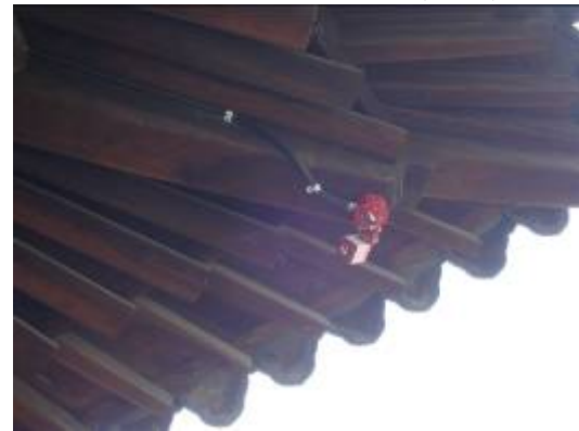
圖 14：煙霧偵測器設置於屋簷角落(昌德宮)
