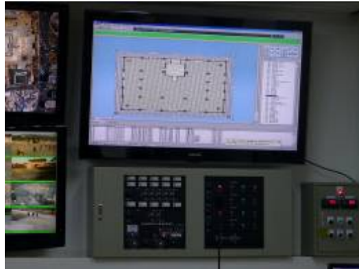
圖 22：景福宮管理站中控室內資訊管理系統
