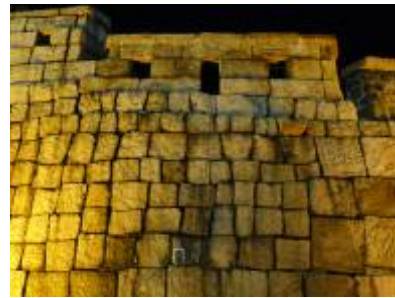
圖 30：東大門壁體之位移監測
