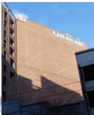
圖 4 Flood Building 側面裂縫
