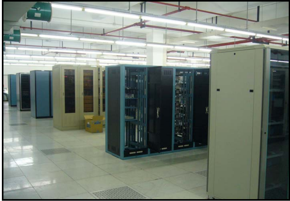
圖 20：上海區域管制中心之機房
