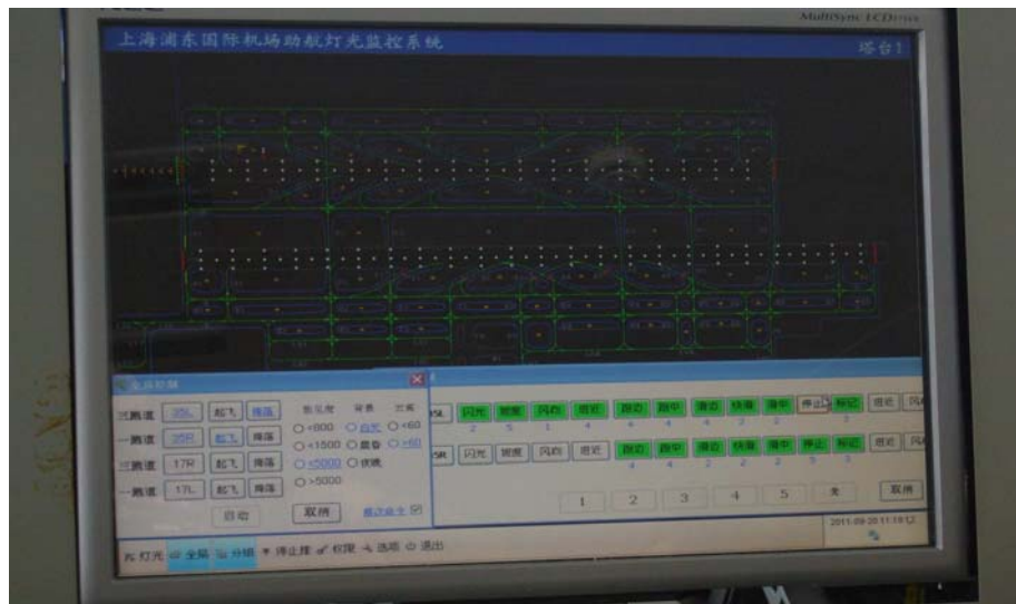
圖 28：浦東機場塔臺之機場燈光控制系統
