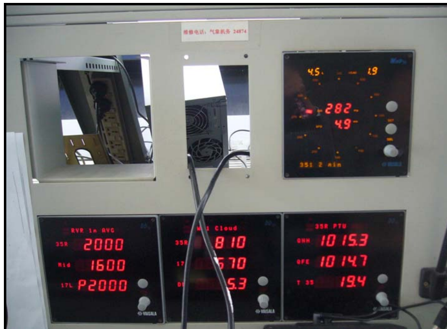
圖 32：浦東機場塔臺管制室之氣象感測器顯示裝置
