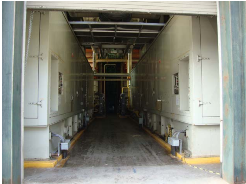
圖 23 Thermal Power Plant。(內部)(感謝 Mr. D. Weil 同意拍攝)
