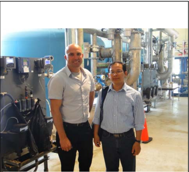
照片 18 參訪 Napier-Reid Ltd. 設計建造的 Greenbrook Water Treatment Facility
