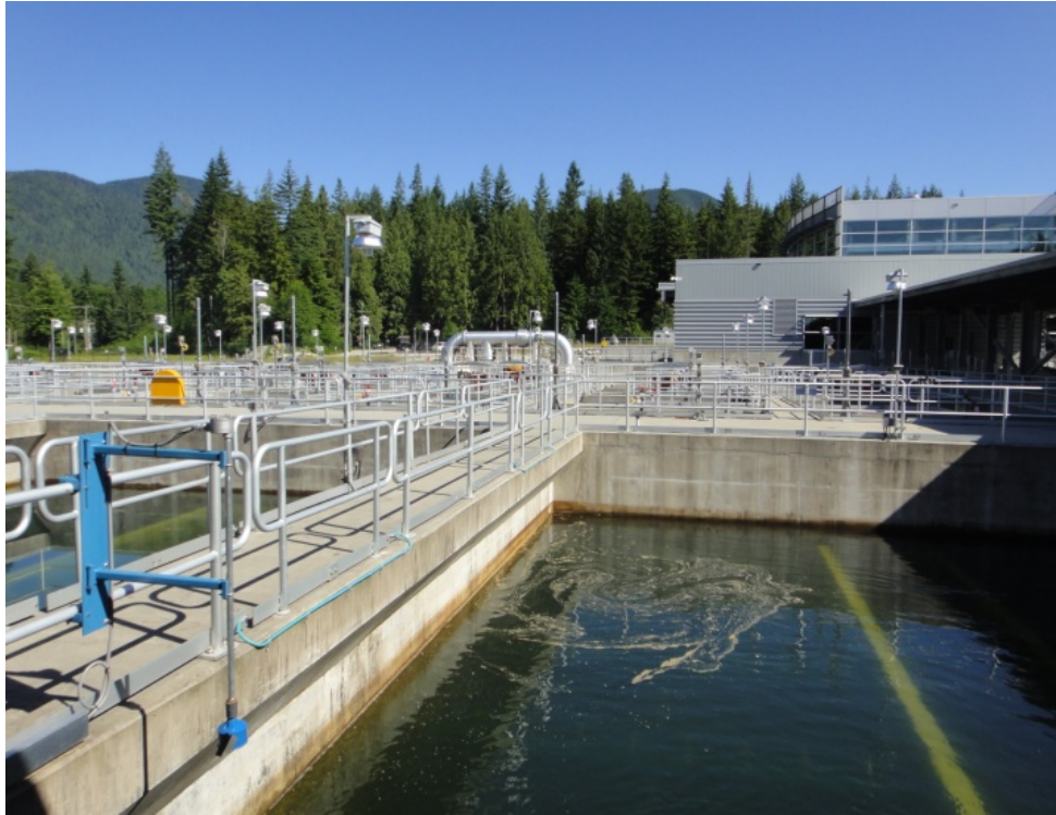
照片 21 Seymour-Capilano filtration plant 之淨水過濾處理
