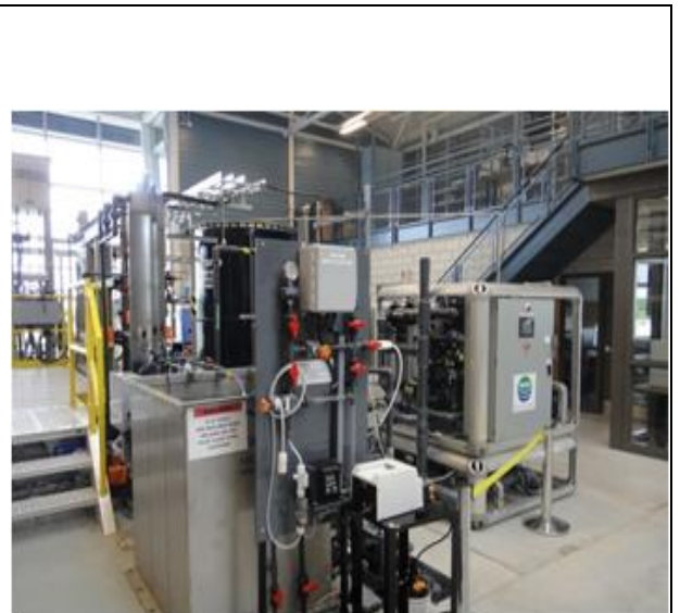
照片 26 渥克頓潔淨水研究中心內部淨水設施
