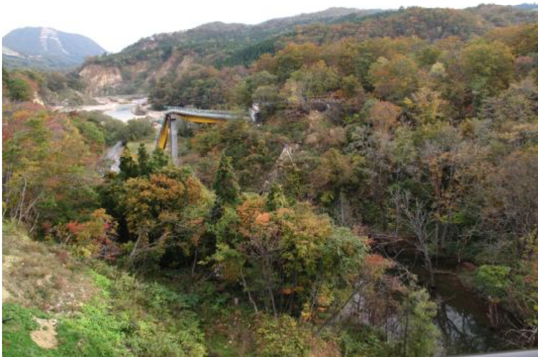
圖 11 岩手縣祭時大橋東側橋台地滑及橋樑毀損現況。
