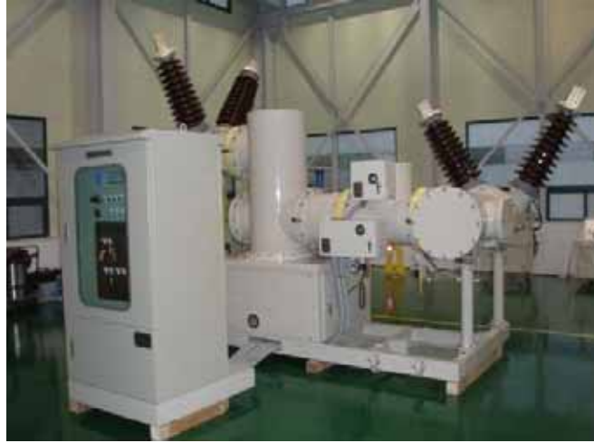
中壓 25.8kV GIS
