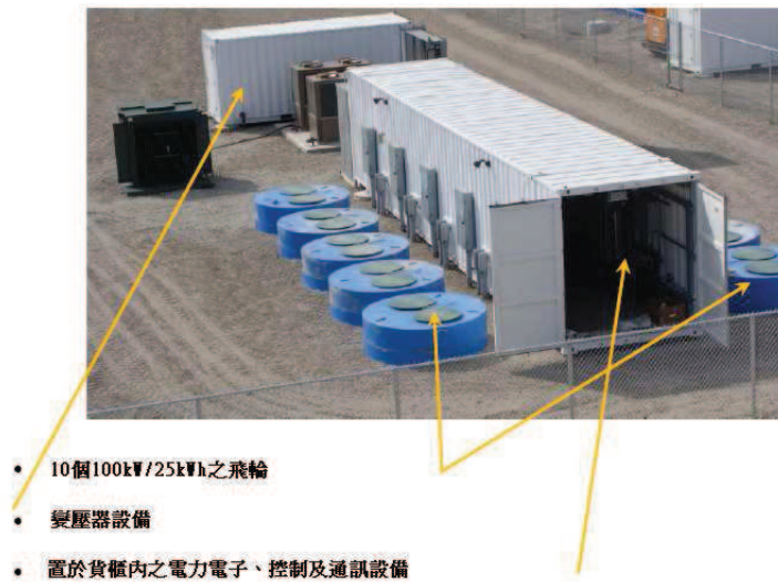
圖 2-11 1MW 飛輪系統
