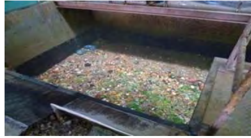
廚餘進料坑(每車5噸直接到入)
