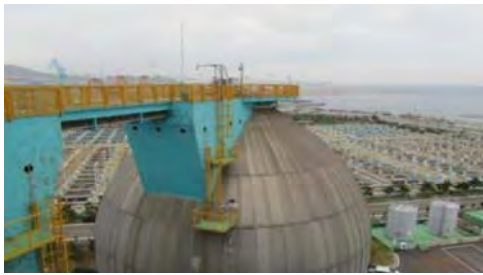
蛋形消化槽(7000m 3 /槽)
