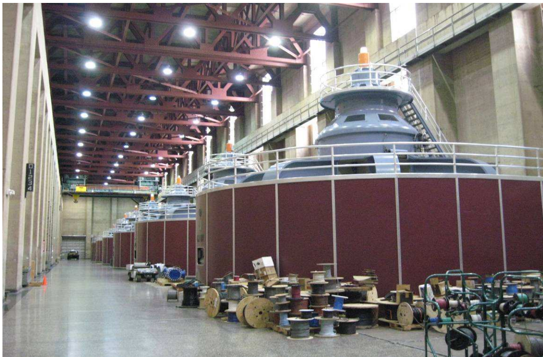
Hoover 壩電廠內部發電機組
