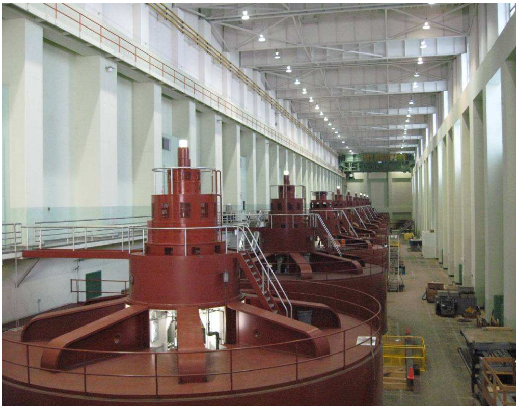
Grand Coulee 壩電廠發電機組
