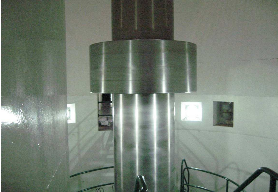
發電設備運轉情形
