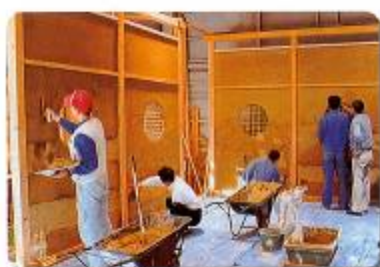
左官科 石割置き引き、小舞掻き、漆喰壁塗り、海鼠壁塗り、漆喰飾り彫刻
