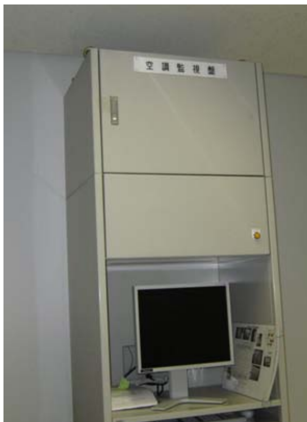
圖 18 氧氣濃度監視主機
