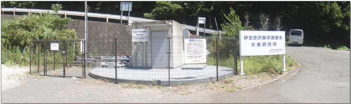
海洋深層水取水設施地面外觀
