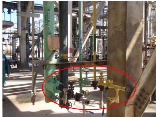
圖 3：公用站管理。管線配置為橫向且安裝快速接頭及 Coke Valve 方便操作。
