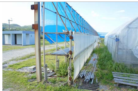
圖 6. 溫室設施旁新建的抗風設施，有助於颱風期間減少溫室損失。
