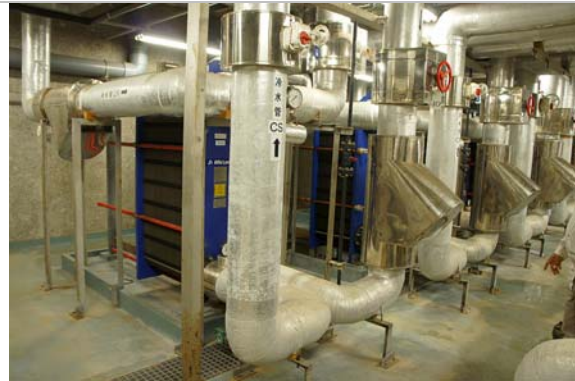
圖 3. 海洋深層水機房內的冷交換機設備。
