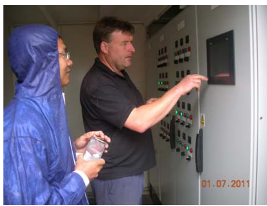
圖 27. David 介紹沼氣發電機操作。
