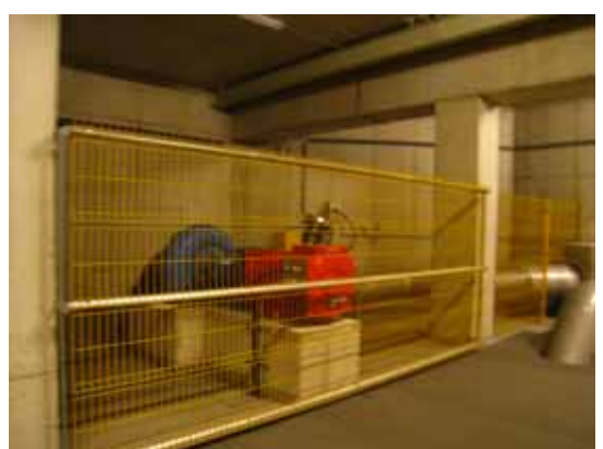
自來水廠之發電機組
