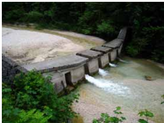
Russbach 攔砂壩讓生物通道動線連貫生態良好
