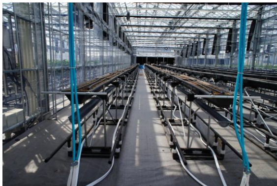
可動式栽培装置現場配置情形
