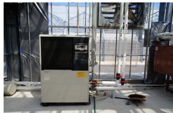
水溫冷却設備及輸送管線
