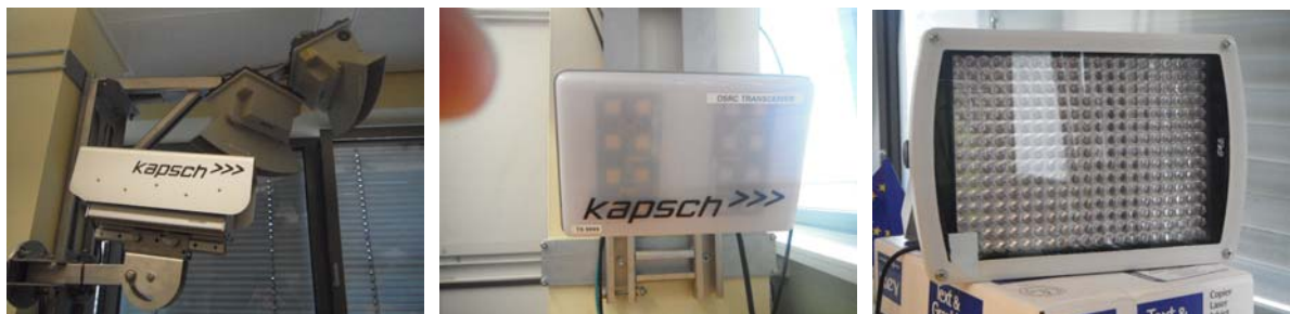
圖60 DSRC車道前端設備展示
