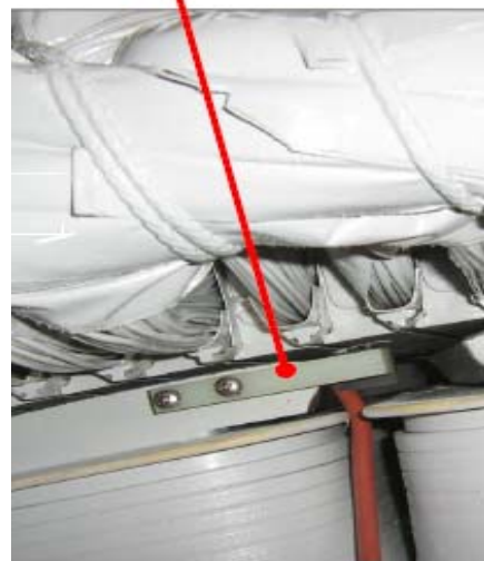
發電機汽隙振動保護
