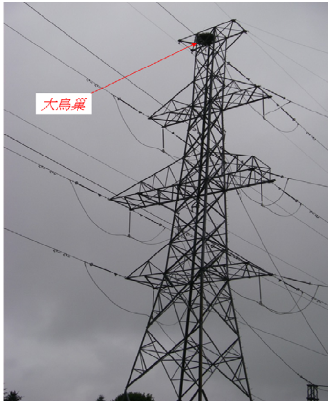
Waterloo 變電所 230kV 輸電鐵塔
