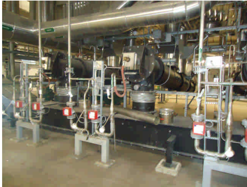
圖：瑞典 Söderenergi 公司之 Igelsta CHP 設備照片
