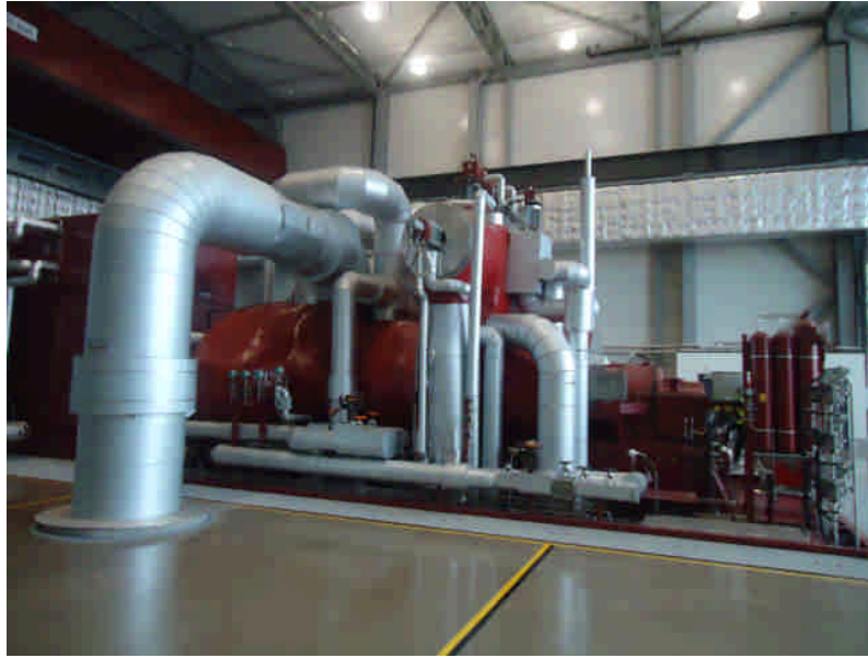
圖：瑞典 Söderenergi 公司之 Igelsta CHP 廠區氣渦輪發電機
