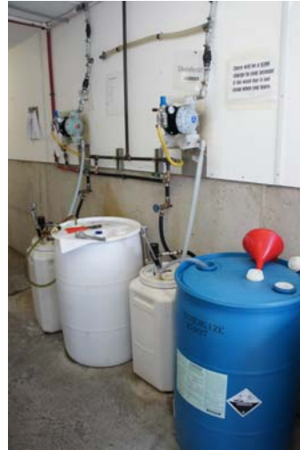
圖 76、廠房內高壓噴霧管線，白桶內為清潔劑，藍桶內為對 PRRS 有效之消毒藥劑，先以清潔劑清洗完畢後，再噴灑消毒水
