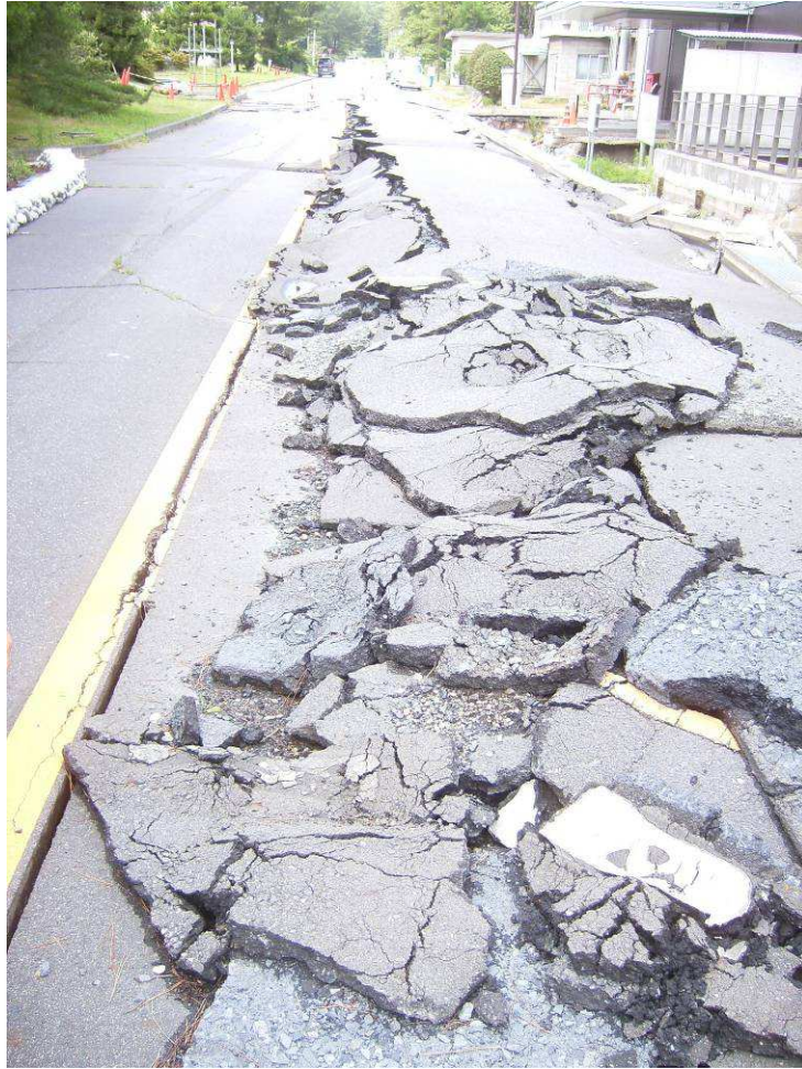
圖38- 直線加速器設施外柏油路面與路基遭受311地震損壞情形
