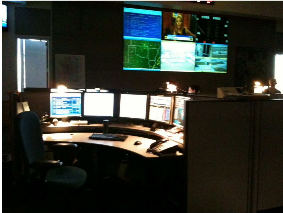
圖：達拉斯機場 AOC 監控辦公室 ( 共 12 席，監控全機場即時安全監控 )
