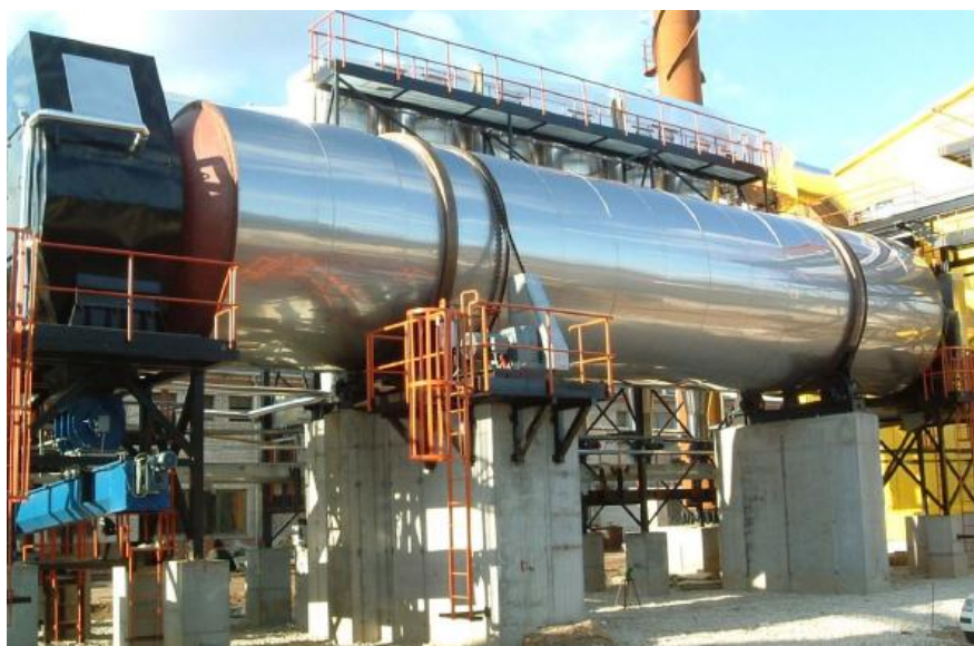
圖 18 脫墨污泥乾化設備
