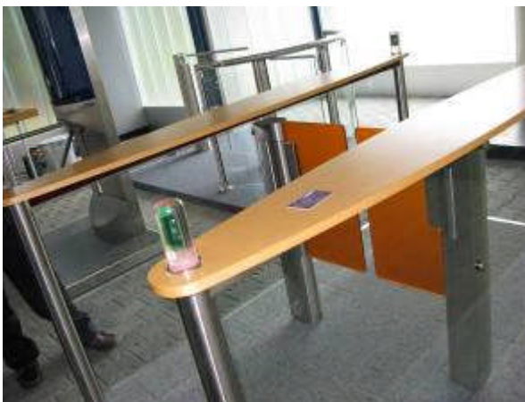
圖 11. 工廠參訪－簡易式驗票閘門
