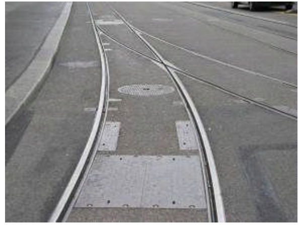
圖 132. 輕軌電車埋入式軌道轉撤器及偵測器及軌道電路
