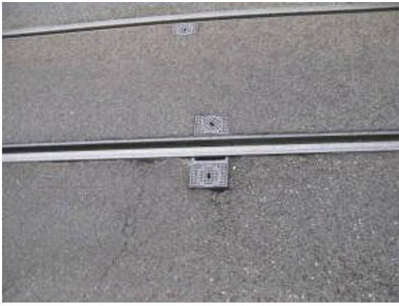
圖 155. 輕軌電車軌道維修孔
