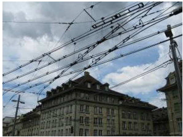
圖 170. 輕軌電車纜線與景觀衝突
