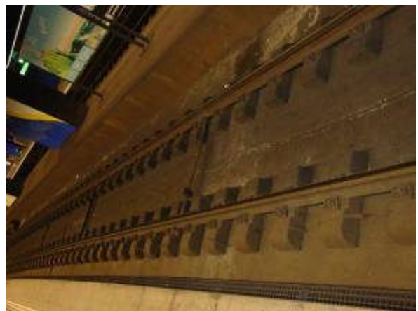
圖 110. 軌道軌枕及軌道電路
