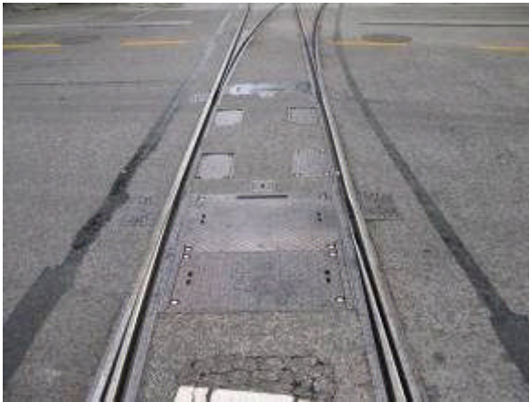
圖 133. 輕軌電車埋入式軌道轉撤器及偵測器及軌道電路
