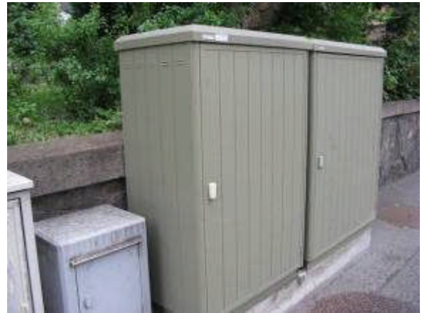
圖 134. 輕軌電車站旁變電箱
