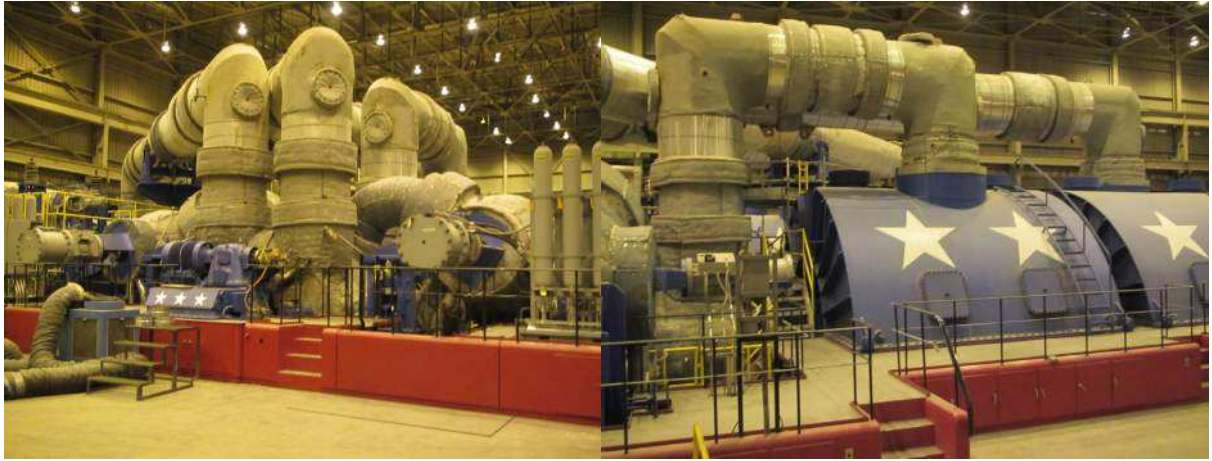
圖 44 Mountaineer 電廠之 1300 百萬瓦(MW)超臨界(SC)燃煤機組渦輪蒸汽發電機
