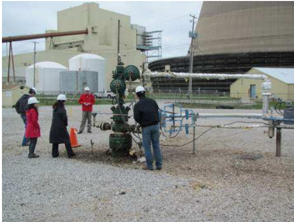
圖 51 參訪團成員觀察注入井管線設備
