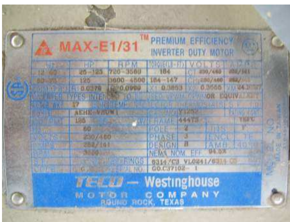
圖 49 發現注入泵品牌為台灣製東元(TECO)馬達
