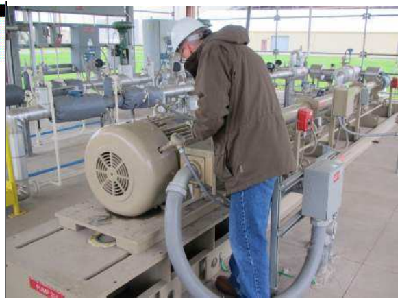
圖 48 Mountaineer 計畫經理查看注入泵品牌
