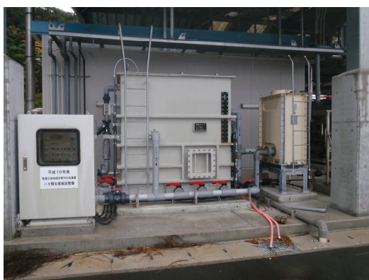
電解海水消毒設施
