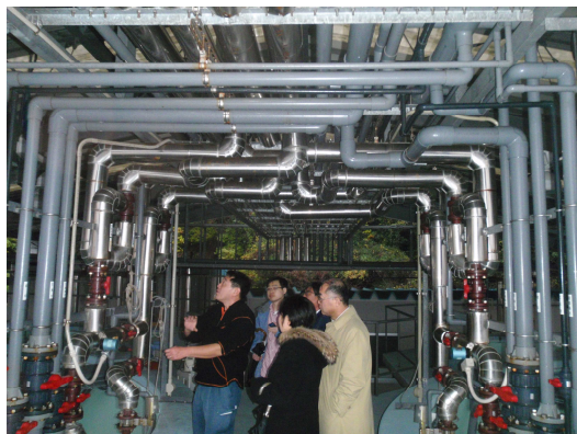
育苗池加溫供水管路
