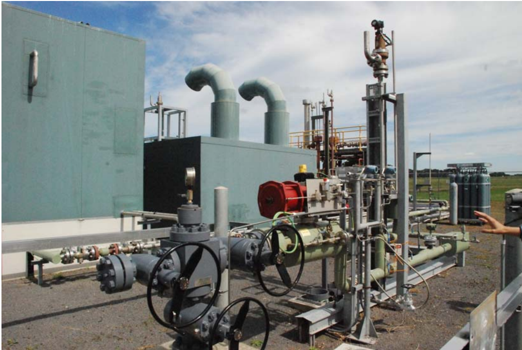
照片十一、地面注氣設備
