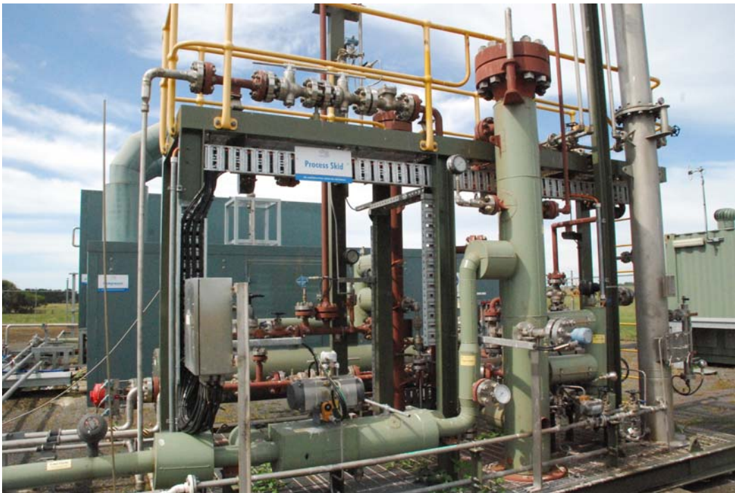
照片十四、地面注氣設備—脫水除蠟
