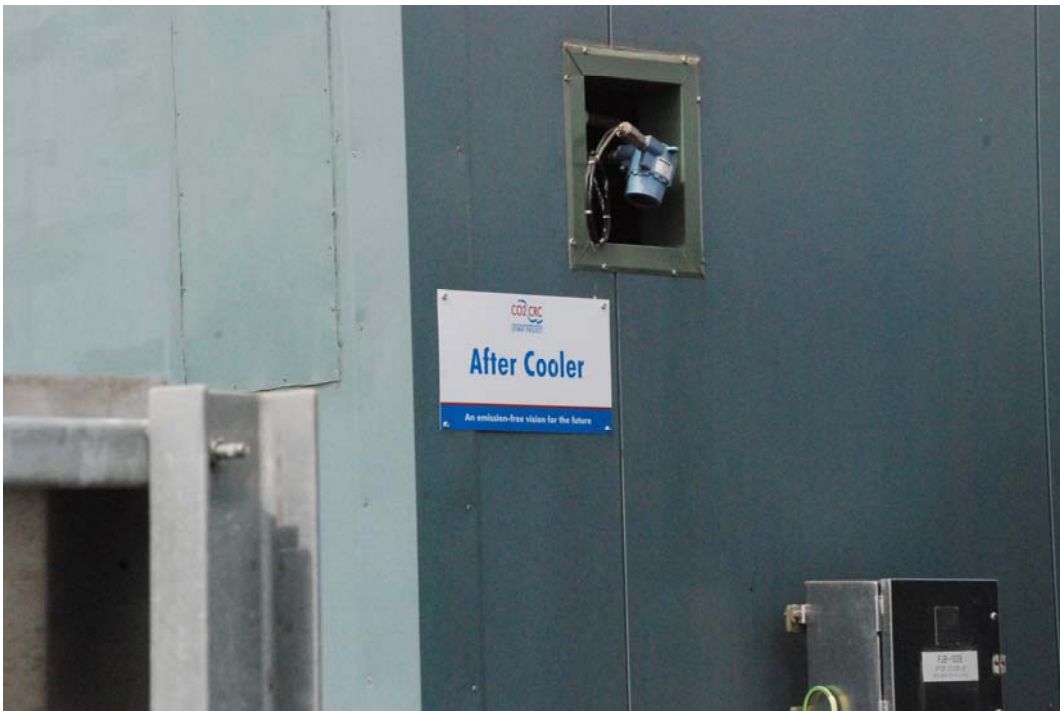
照片十二、地面注氣設備—冷卻系統
