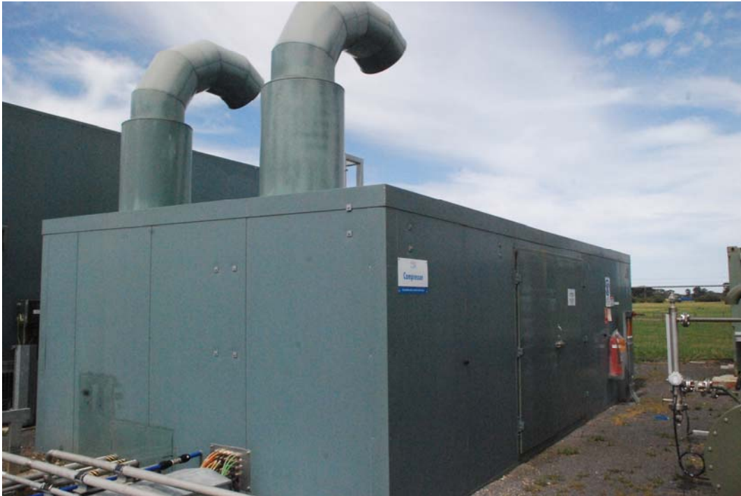
照片十三、地面注氣設備—壓縮機
