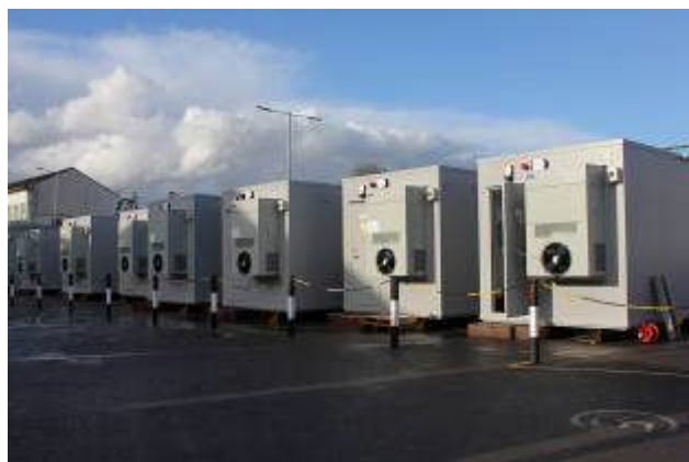
戶外型號誌設備站
