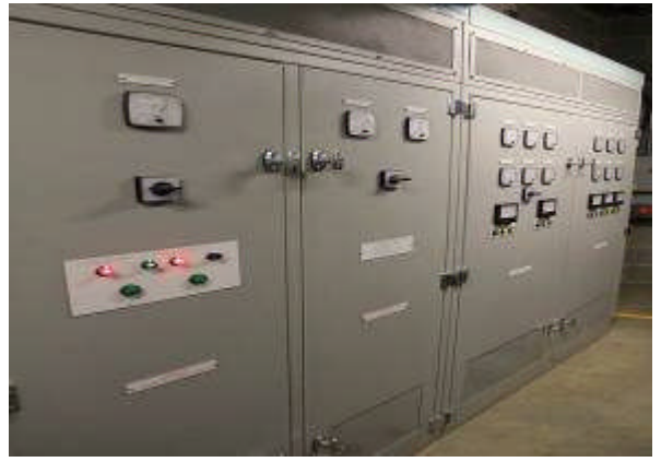
號誌電源供應箱
