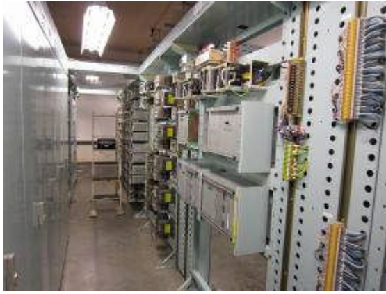
白城駐車軌號誌設備室
