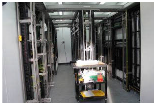
戶外型號誌設備站內部
