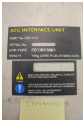
TIU 電氣廠牌型號檢查
