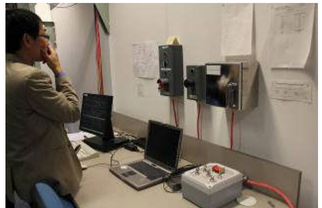
車站緊急停車按鈕及鑰匙開關箱等模擬設備
