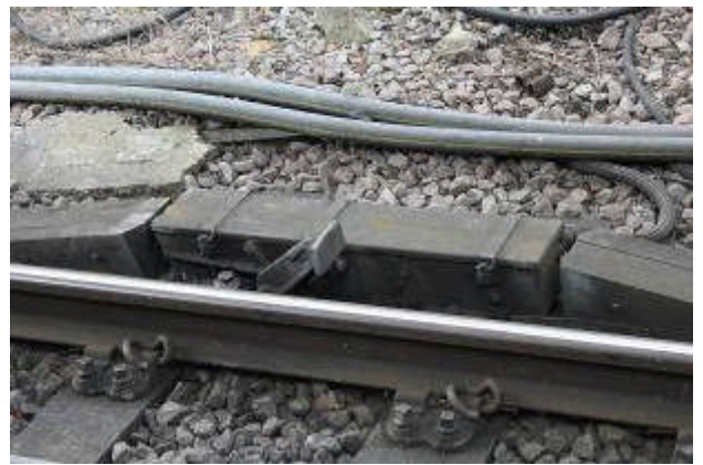
軌旁列車停車器(TRAINSTOP)
