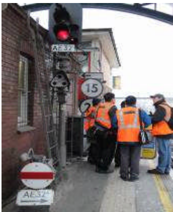
月台端門旁號誌機
