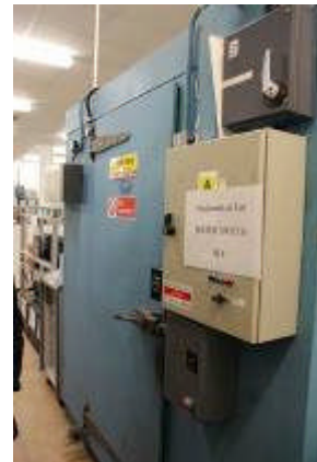
ATP 環境測試 Soak-Test 測試箱外部
