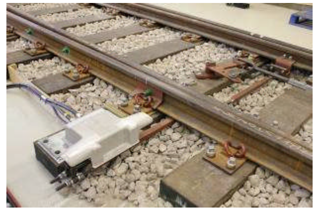
Surelock 轉轍器之輔助偵測桿設備
