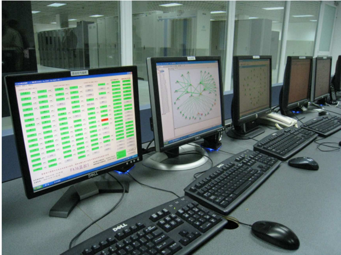
圖 3-8 參訪廣州區域管制中心設備監控室
